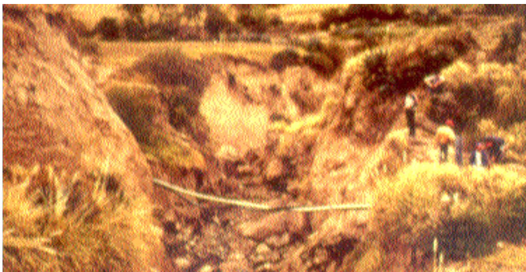
Tubería sin protección, ubicada en el cruce de río
